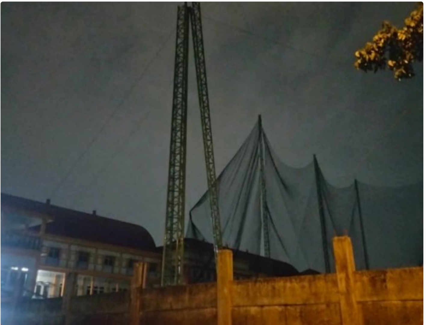
Tiang bangunan lapangan golf mini yang berada di Jalan Pancing, Kelurahan Indra Kasih yang tumbang, Kamis (10/11)
